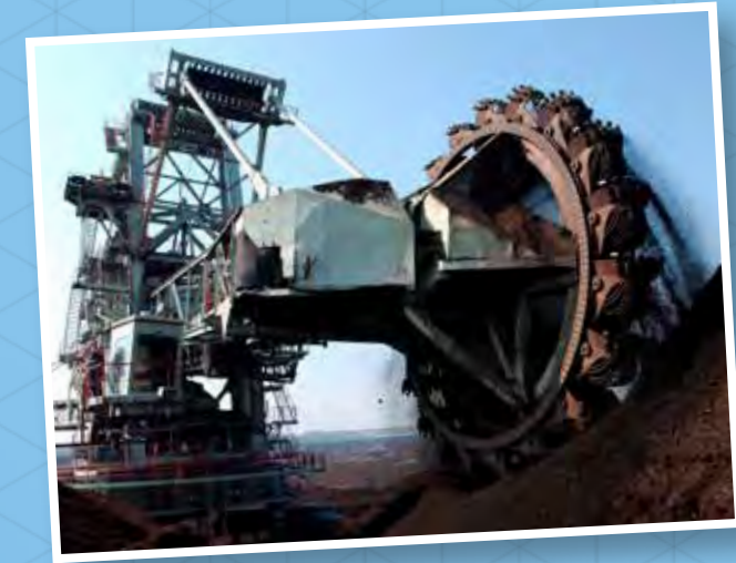
Bij de bouw van een mijn of een andere ondergrondse constructie worden gigantische graafmachines gebruikt.
