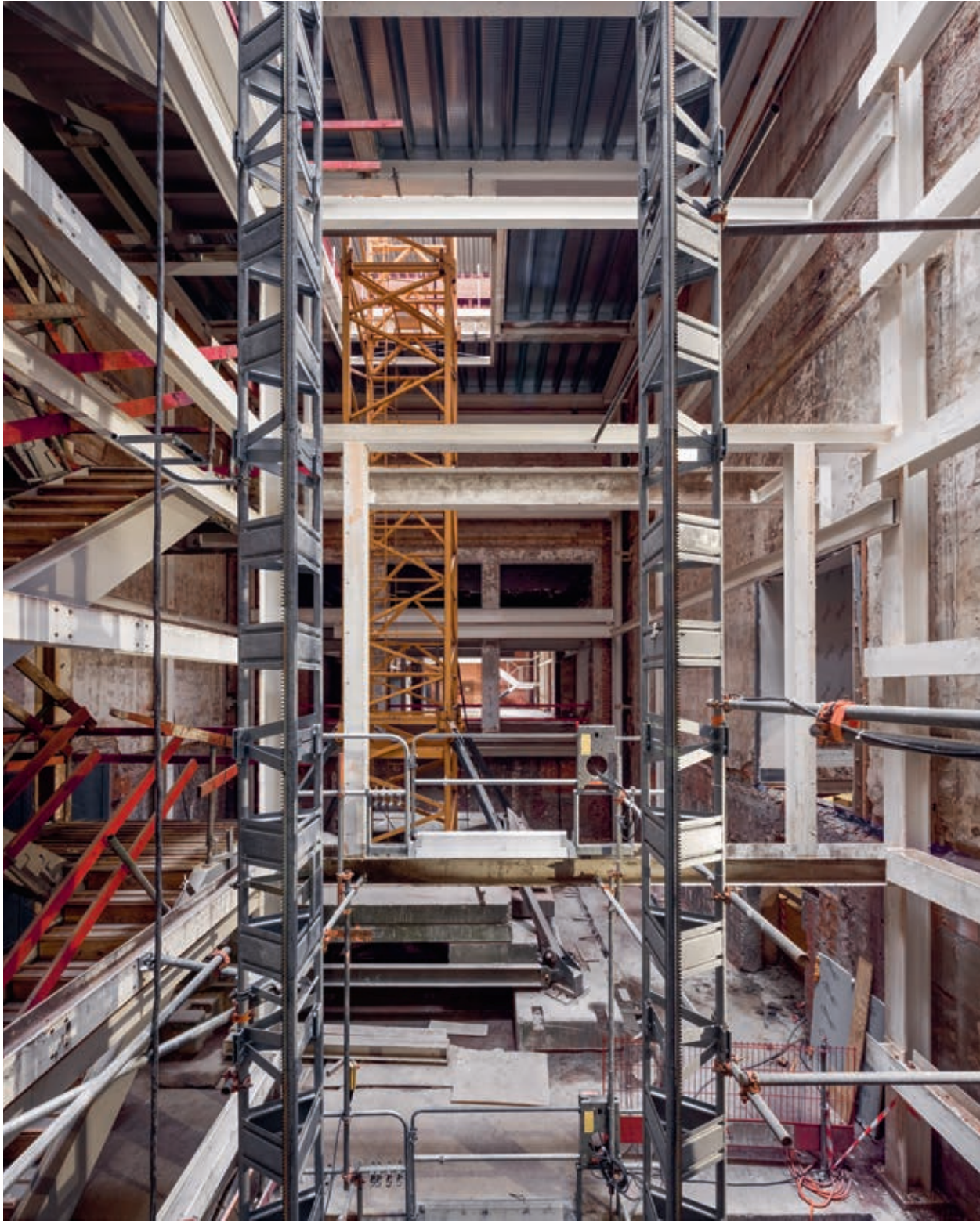
Om het nieuwe museumvolume vorm te geven werd een staalstructuur geplaatst van in totaal 1.000.000 kilogram.
