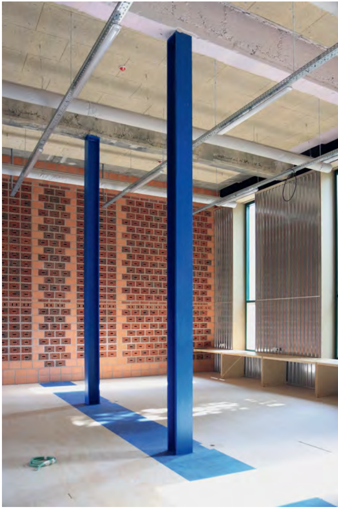
Carelessly executed concrete columns were replaced with steel columns painted in traffic blue. | De onzorgvuldig uitgevoerde betonkolommen worden vervangen door staalkolommen die in 'verkeersblauw' worden geschilderd.
