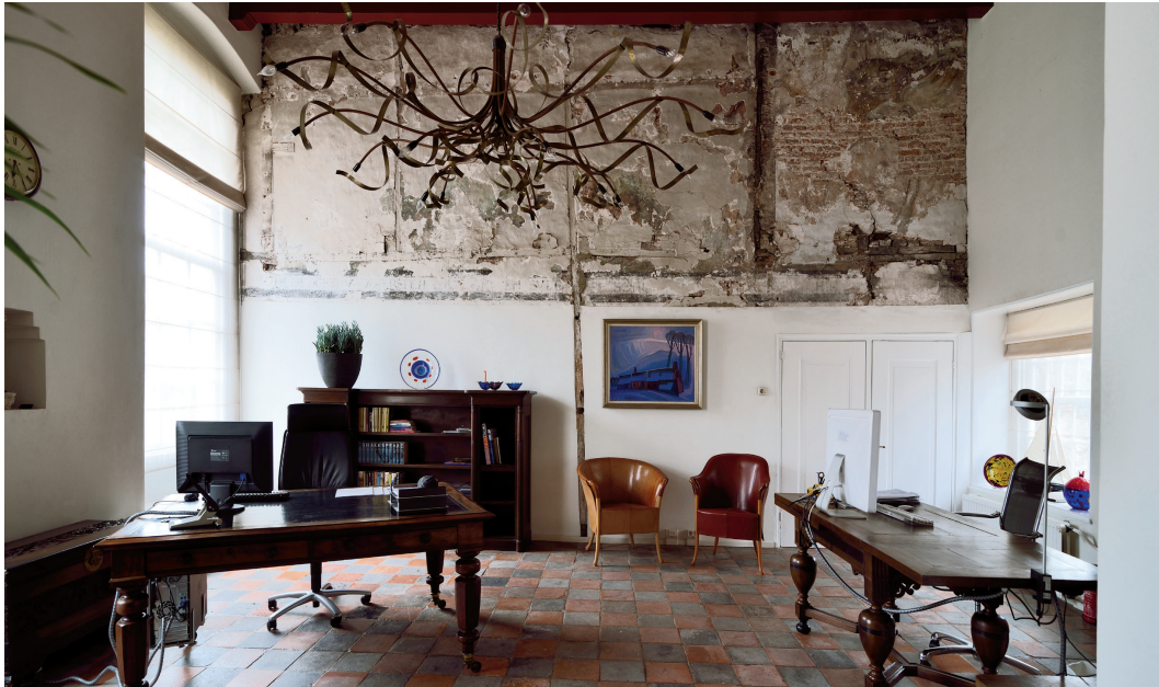
Ruimte 0.3 op de bel-etage. Op de achterwand bevindt zich een muurschildering van het Laatste Oordeel uit de tijd van het lint- en spinhuis. Links is een stukje zichtbaar van een dubbele kaarnsis uit de bouwtijd.
